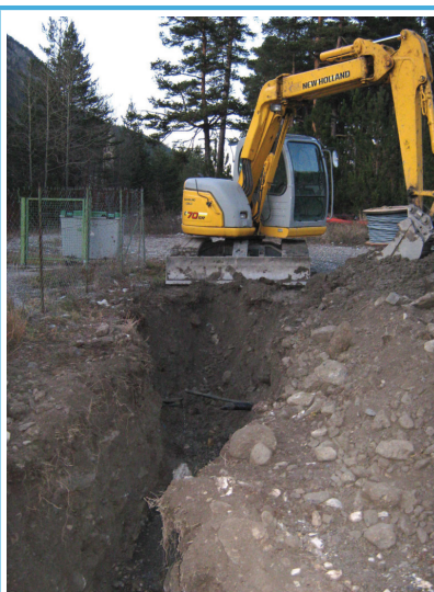
Création du réseau de raccordement du PR existant de La Vachette au PR "Pont RN 94"
