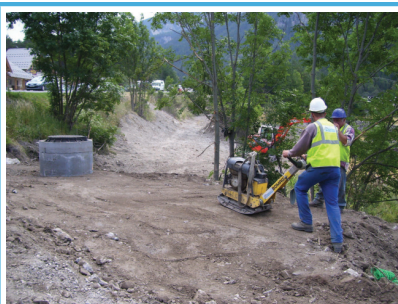
Juil.09 : Réaménagement du débouché sur la RN94 (élargissement et reprise du profil)
