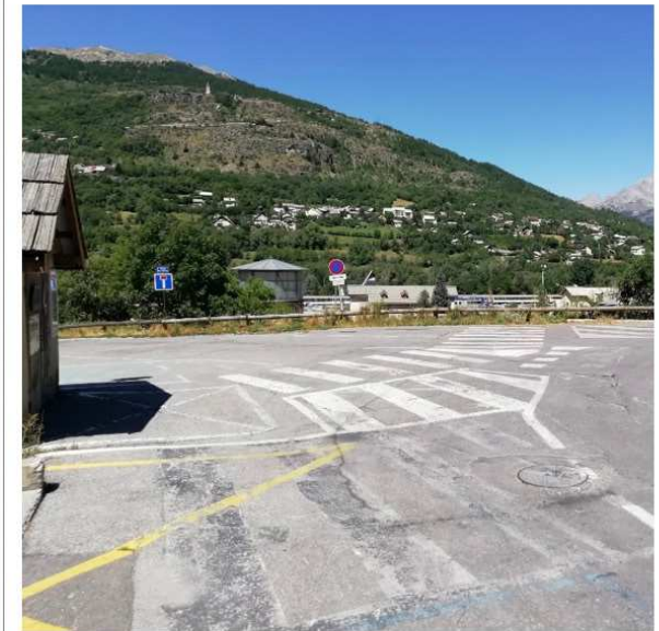
Cheminements mal définis, marquages peu visibles (giratoire Chemin de l'Emparre / rue Alfred Mondet)
