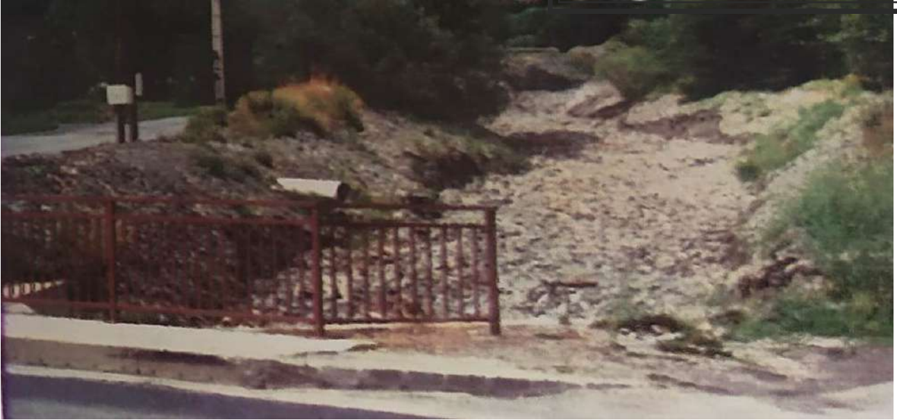
Photo 43 : Dépôt en amont de la RN 94 en 1995
