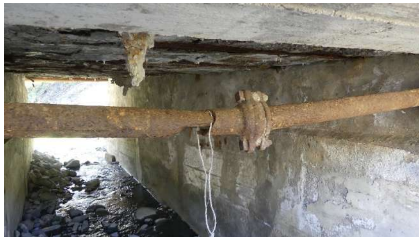
Figure 114 : Réseau vétuste, (abandonné ?) côté amont
