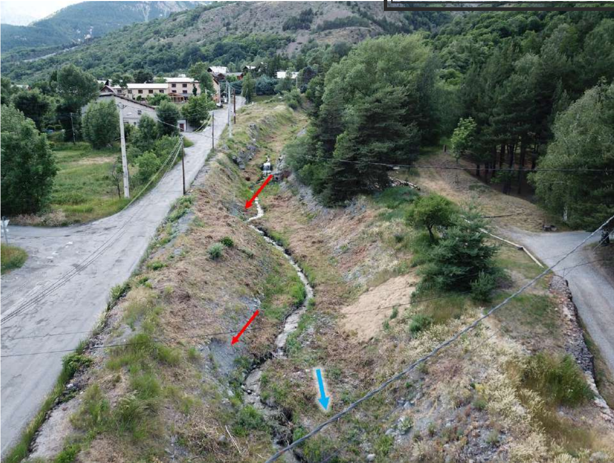
Figure 125 : Points d'érosion du talus côté torrent sur le talus aval
