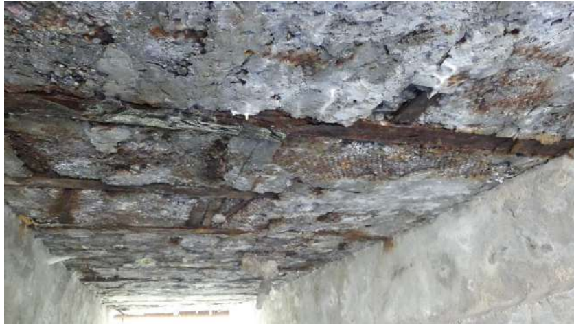
Figure 113 : Dalle en très mauvais état
