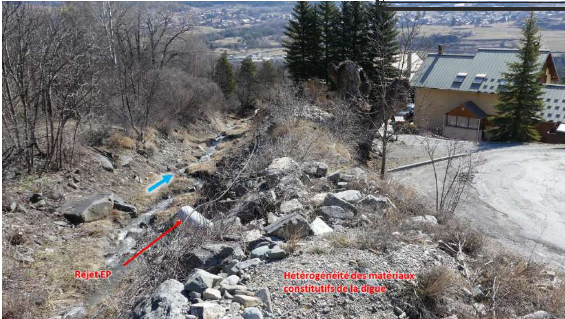
Figure 126 : Rejet EP traversant la digue au droit du PT05
