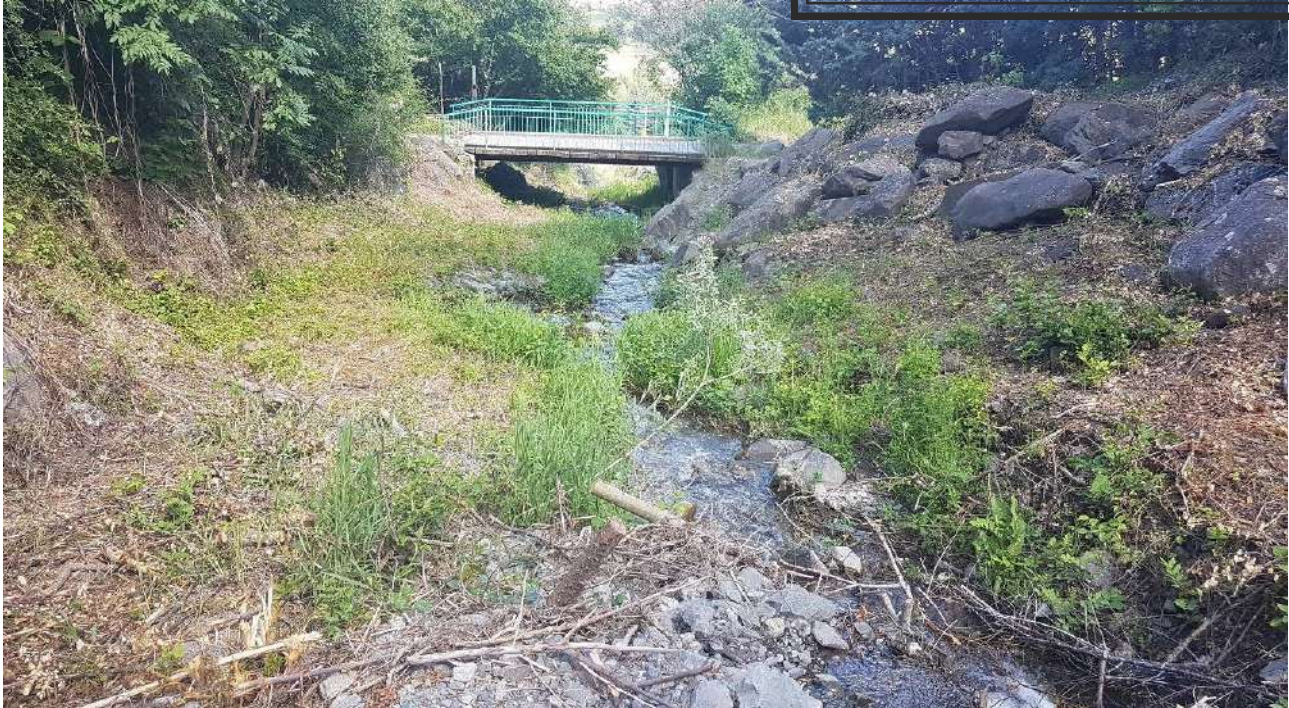
Photo 30 : Faible hauteur et entonnement peu progressif pour le pont de la Vignette
