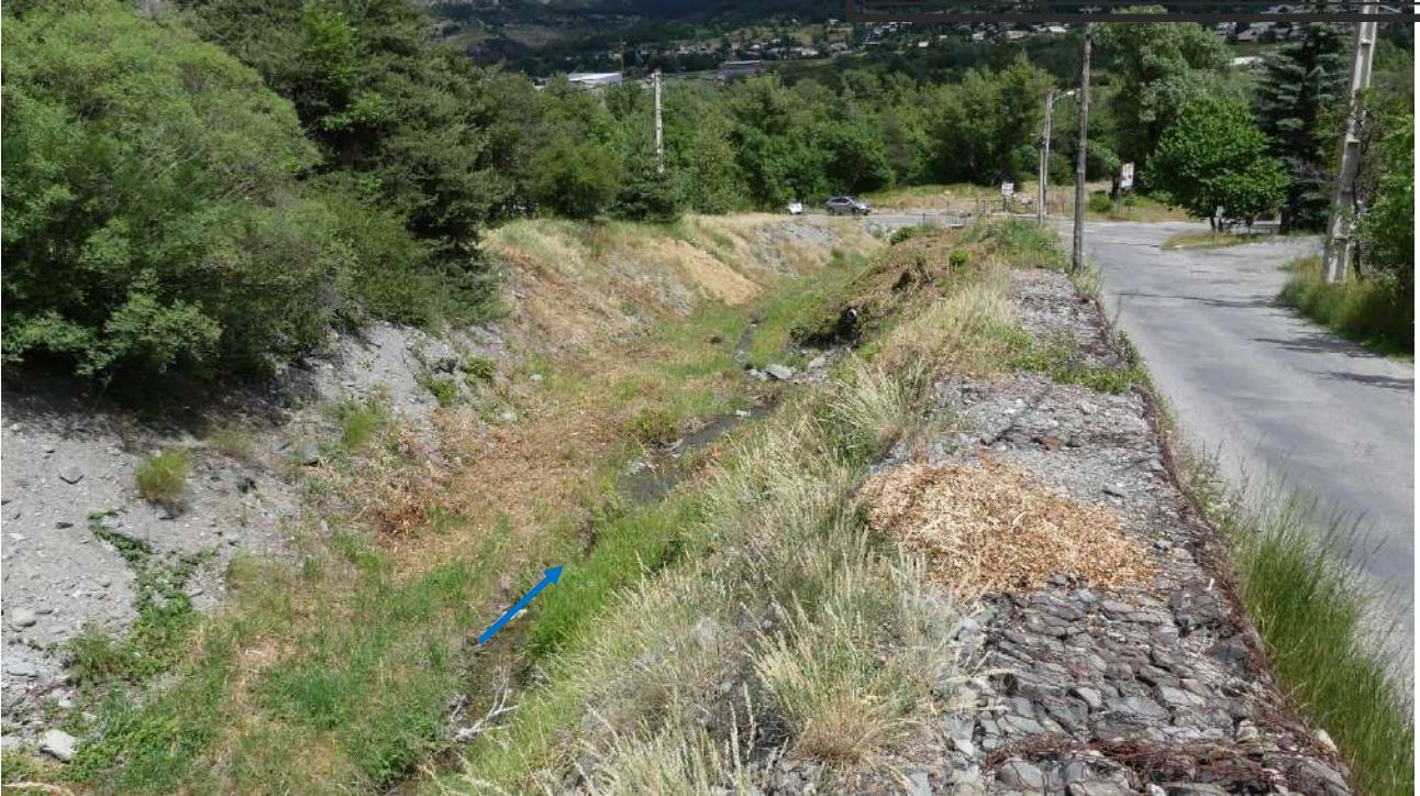
Figure 94 : Photographie de la rangée de gabions longeant la route – tronçon aval en amont du pont de la RN 2094
