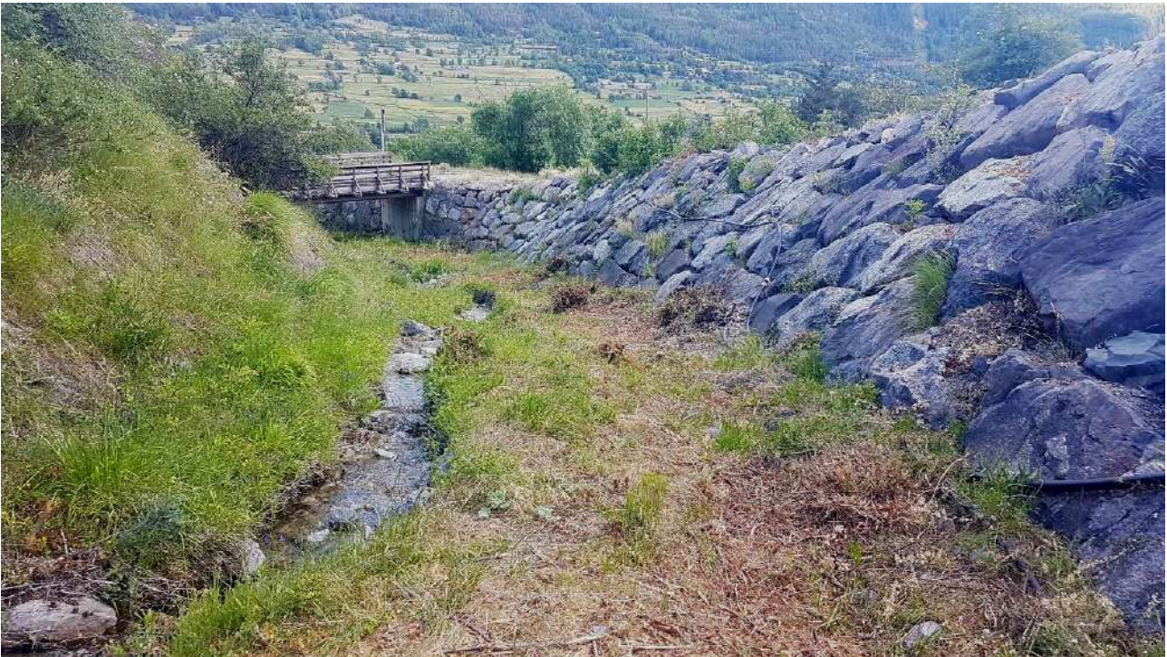
Photo 20 : Entonnement du pont du Rif Claret
