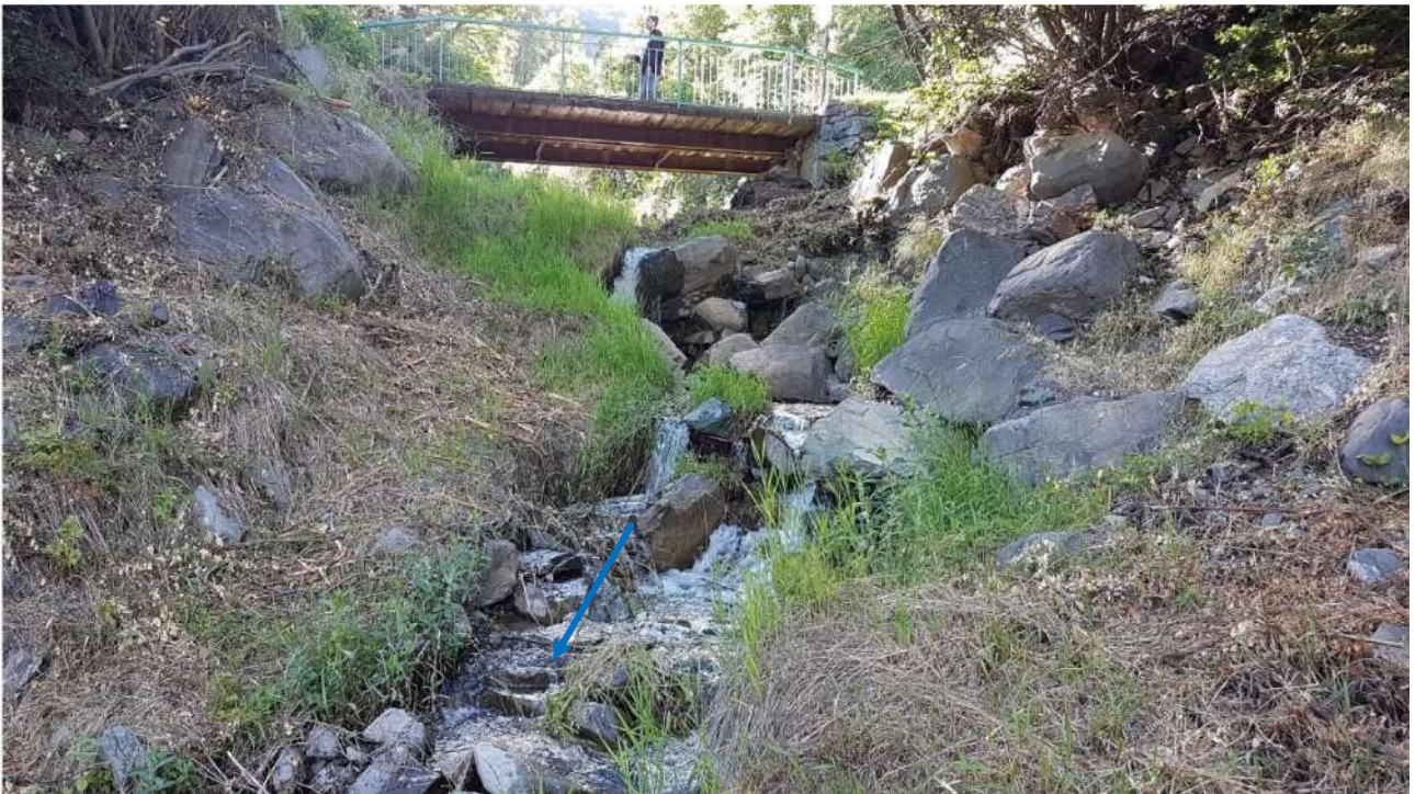
Figure 118: Seuil de prise d'eau en aval du pont de la Vignette Basse
