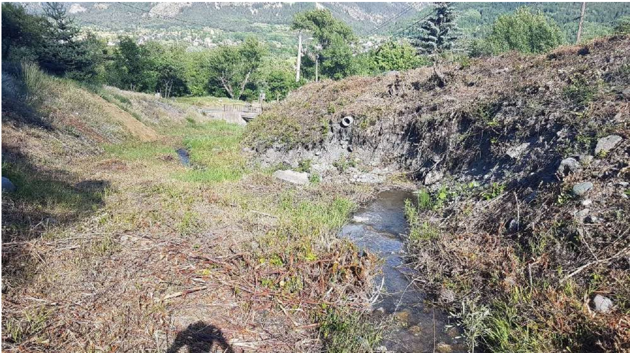
Photo 34 : Absence de protection de berge... et érosion, même pour des débits ordinaires
