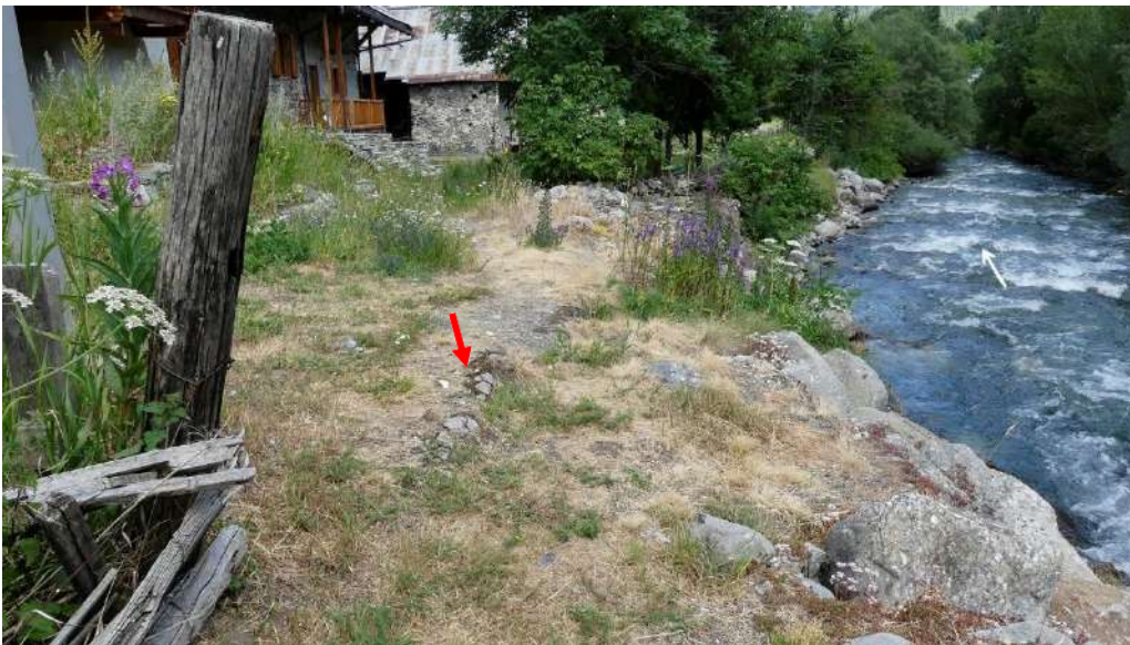
Figure 11 : Digue de Ville Haute – vue vers l’aval en amont du profil P8a et gabions affleurants
