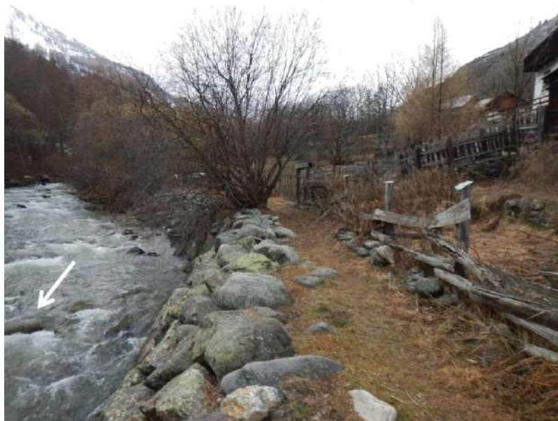
Digue de Ville Haute - enrochements au droit du profil 8, vue vers l'amont
