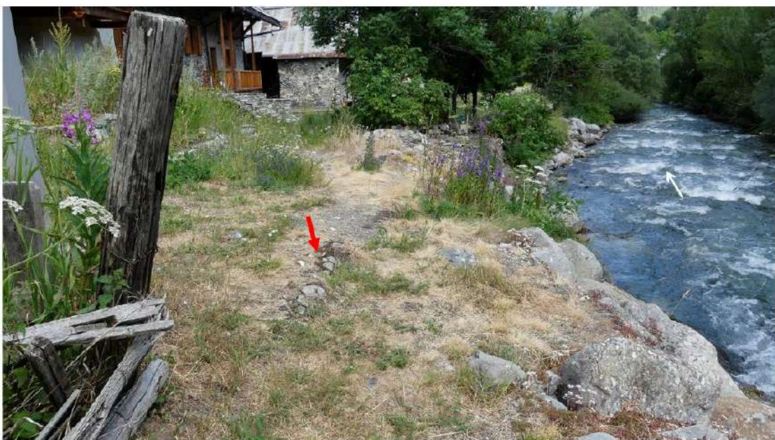
Digue de Ville Haute – vue vers l'aval en amont du profil P8a et gabions affleurants
