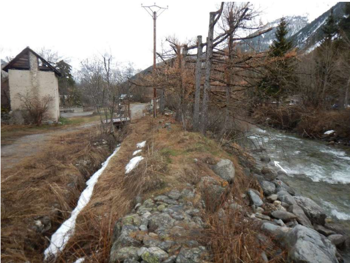
Figure 17 : Digue de Ville Haute - Vue vers l'aval en amont du profil P9a
