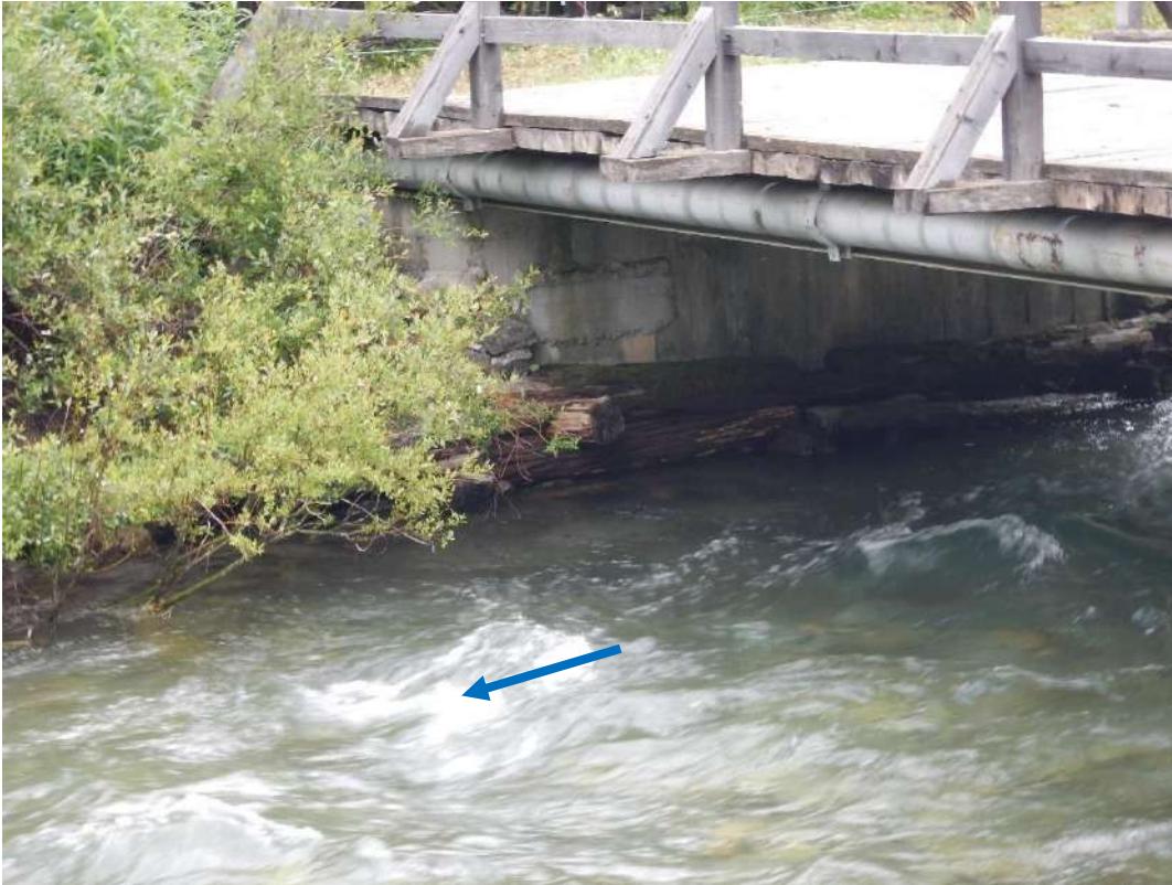
Figure 66 : Conduite BT ENEDIS en encorbellement côté aval du pont de Ville Basse
