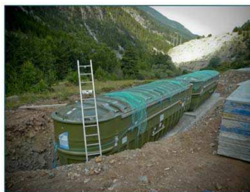
Les cuves de la STEP
